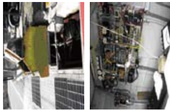
▲川上ミニ水力発電所(左:発電所/右:変電設備)
