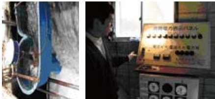
▲駒沢ミニ水力発電所(左:発電所/右:電力パネル)
